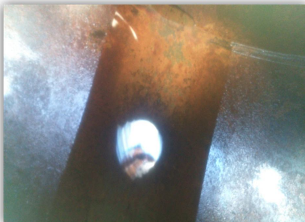
En ésta, se muestra la oxidación y corrosión de las pipas por dentro de la propia cisterna.
