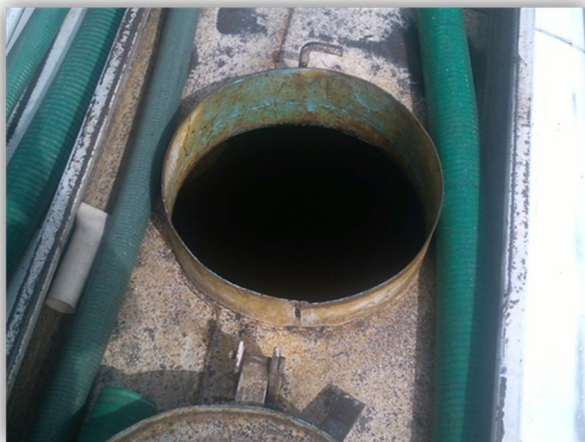
Aquí se encuentra la entrada principal de la pipa con su tapa de cierre hermético, de la misma manera muestra oxidación y corrosión.
