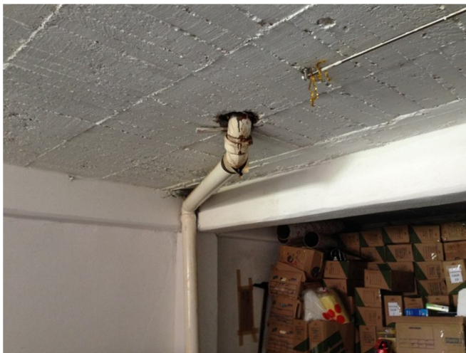
Tubería de drenaje en la bodega.
