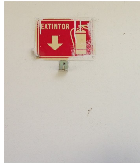
Señalización de extintor pero no existe ningún extintor en el comedor de la Primaria Tierra y Libertad.
