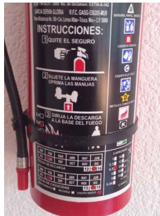
Extintor del patio interior de la Estancia, con carga caduca
