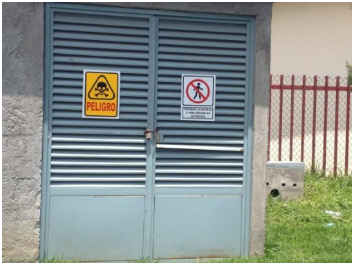
Subestación eléctrica bajo llave
