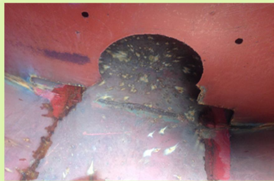
Rompeolas en mal estado
