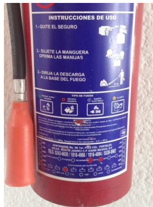
Extintor del edificio dos, con carga caduca
