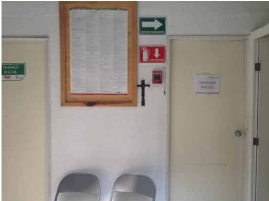
Señalización de extintor sin extintor
