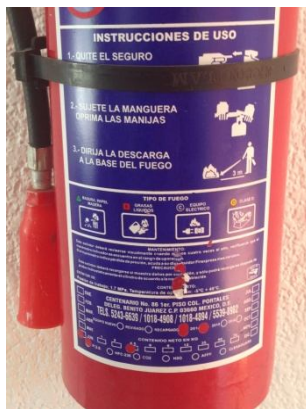
Extintor de la entrada principal, con carga caduca
