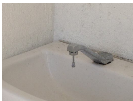
Fugas de agua en los grifos
