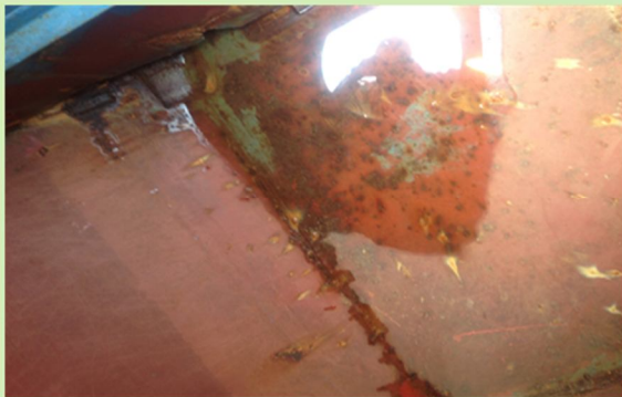
Interior de Pipa cisterna con oxidación y corrosión
