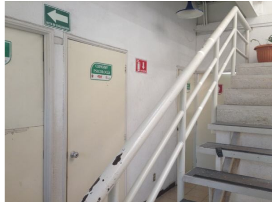
Otra señalización de extintor sin extintor
