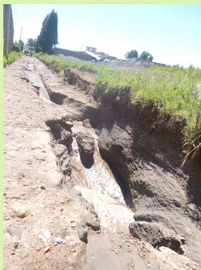
Camino de la calle 16 de Septiembre tapa del pozo botada
