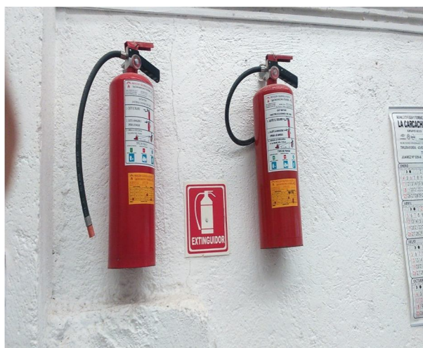
Los extintores están colocados de manera inapropiada.
