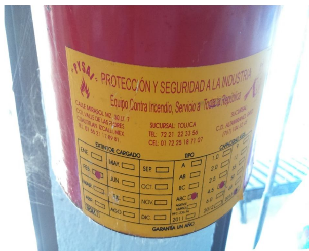
Aquí se muestra que los extintores del APAS están caducos.
