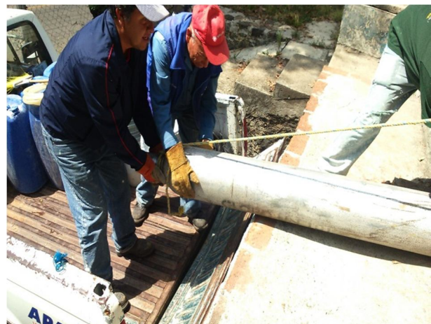
Es colocado de forma horizontal, cuando éste debe ser de forma vertical.
