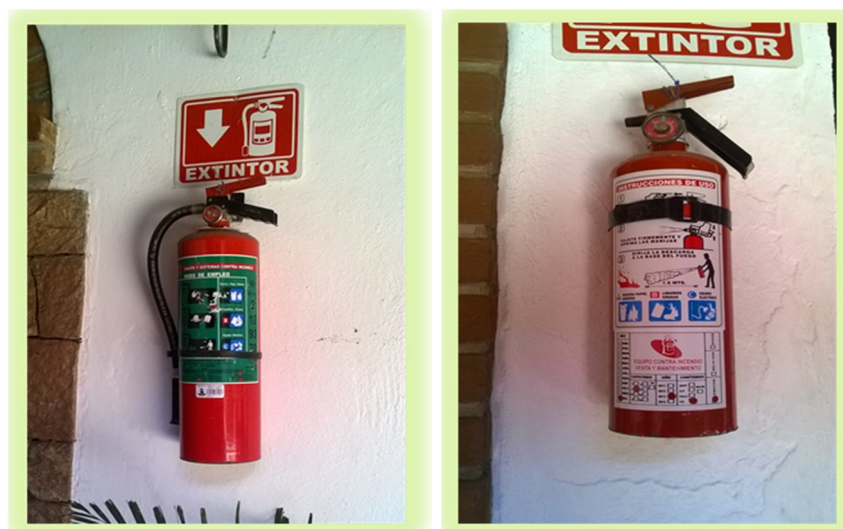
Extintores con carga caduca del edificio central.
