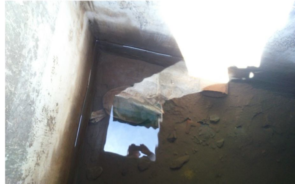
Presenta azolve y falta de mantenimiento
