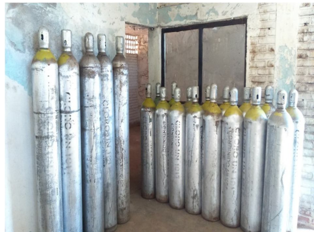
Los cilindros no están separados y la bodega presenta humedad.
