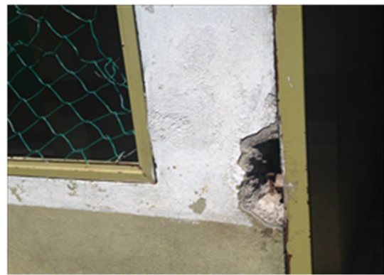
Muestras de vandalismo en las instalaciones.
