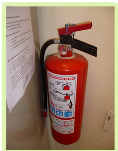
Extintor con carga caduca.
