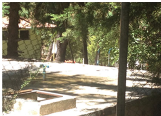
Malla rota con acceso al pozo A.P.A.S. sin tapa.
