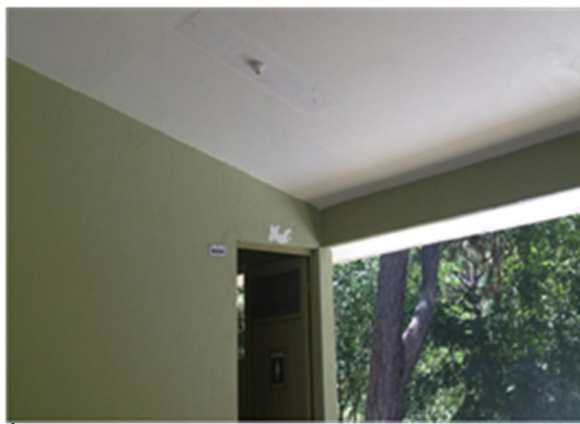
Áreas de uso común sin iluminación.
