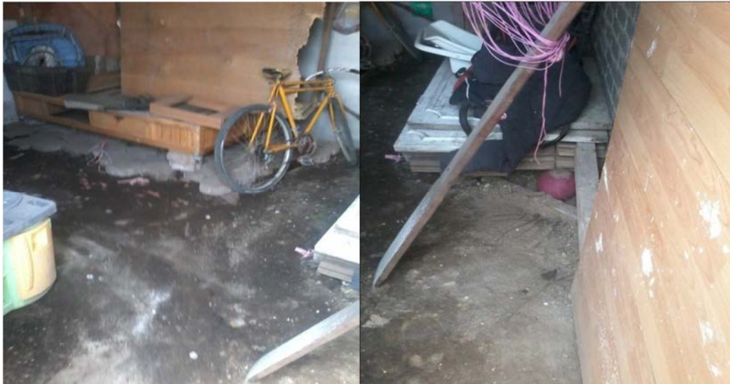
Piso de tierra en dormitorio de Chalco.
