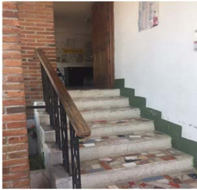
Escaleras del acceso principal sin señalización ni antiderrapante.
