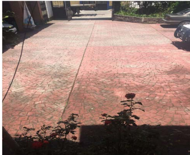
El estacionamiento no cuenta con señalamientos ni delimitaciones.
