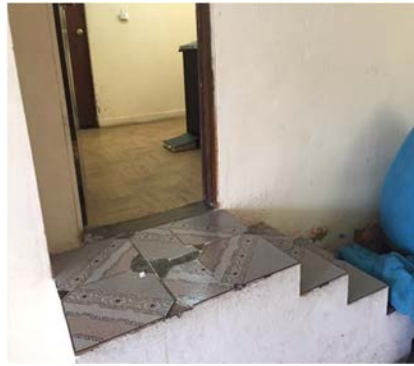
Escaleras sin barandales, sin señalización ni antiderrapante.
