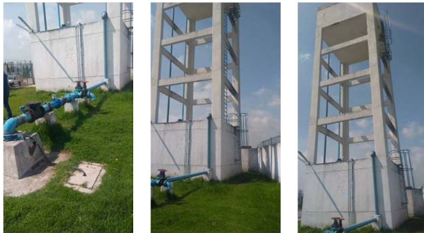
Pozo y tanque de almacenamiento "Rincón del Álamo"
