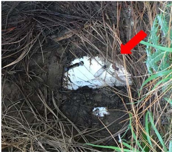
En la imagen se observa perforaciones en la línea principal de distribución.
