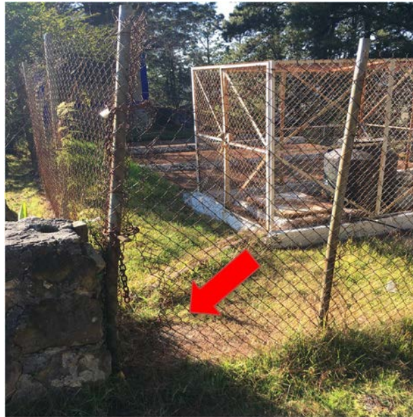
Desperfectos observados en la malla metálica perimetral del tanque de almacenamiento de agua.
