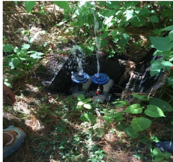
En la imagen se observan fugas de agua en las valvulas.
