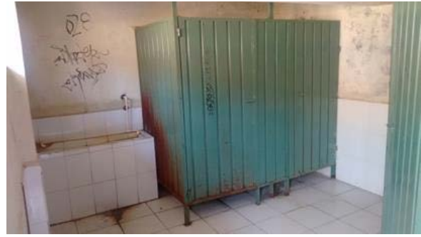
La imagen muestra falta de pintura.
