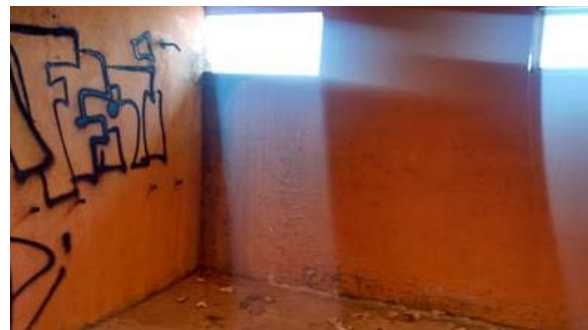
La imagen muestra que no se cuenta con ventanas o vidrios.
