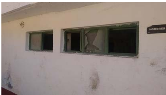
Los baños carecen de vidrios.
