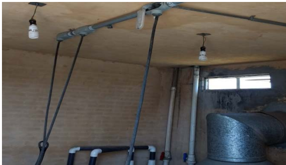
Las tuberías no están identificadas por colores como lo indica la Norma Oficial Mexicana.
