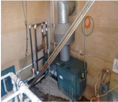
El área de la caldera no tiene señalización de restricción
