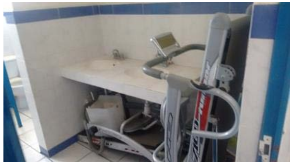
Un aparato del gimnasio se encuentra en los baños del inmueble.
