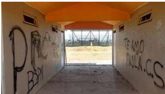
Esta imagen muestra la falta de pintura y limpieza.
