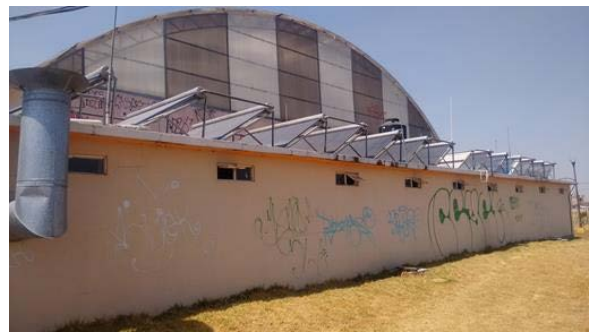
Algunos calentadores solares carecen de tubos colectores de vidrio.
