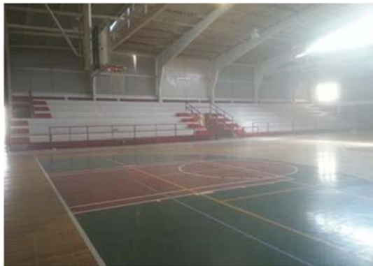
La cancha de Básquetbol carece de extintores, rutas de evacuación y salidas de emergencia.
