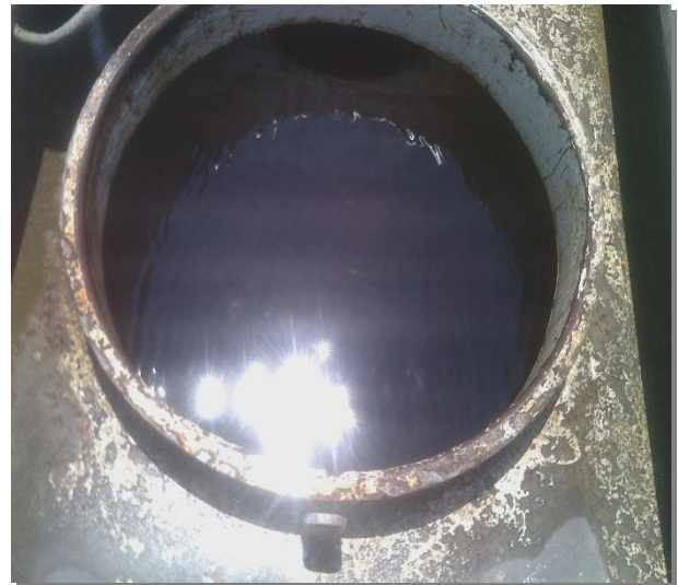
Aquí se muestra la oxidación de la entrada de la cisterna de la pipa del Ayuntamiento de Cuautitlán.
