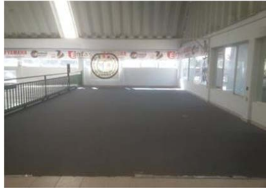
El Área de Taekwondo no cuenta con rutas de evacuación en los muros.
