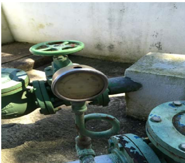
En esta imagen se puede observar que el aparato de la presión del agua no funciona.
