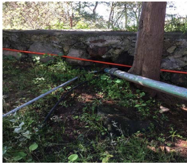
La fotografía muestra que el tanque de agua no tiene barda que impida el paso.
