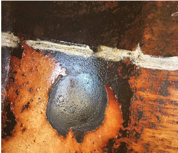
En esta imagen se observa la oxidación y corrosión al interior de la pipa.
