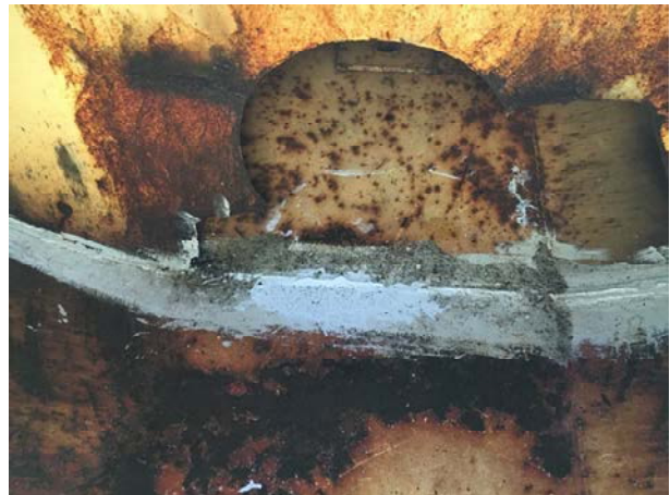
En esta imagen se observa que los rompeolas de la pipa se encuentran en mal estado.
