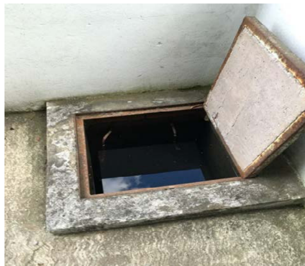
La tapa del tanque no cuenta con candado
