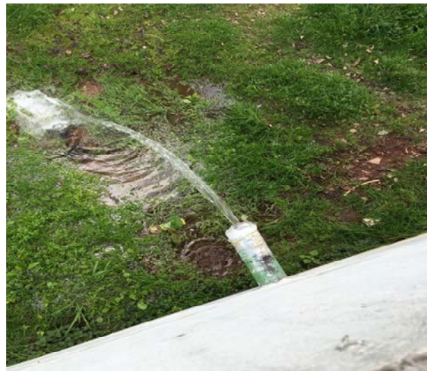
En la imagen se puede observar cómo se desperdicia el agua.
