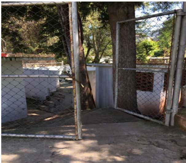
La puerta de acceso principal al tanque, se encuentra abierta y no se cuenta con personal de vigilancia.
