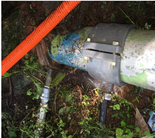
En la imagen, se observa que la línea principal presenta Fugas.
