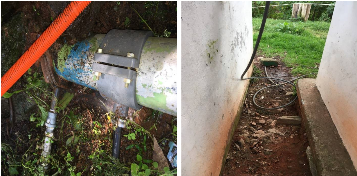
En estas imágenes se puede observar la existencia de una fuga de agua en la línea principal.
