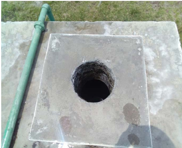
Se muestra uno de los orificios en la parte superior del depósito en donde se pueden introducir agentes contaminantes.
