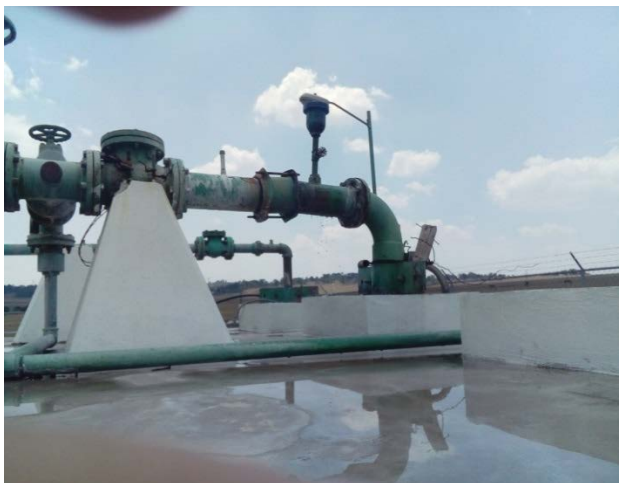
Existe una fuga que ocasiona encharcamiento en la parte superior del depósito y el oxidamiento de la tubería.
