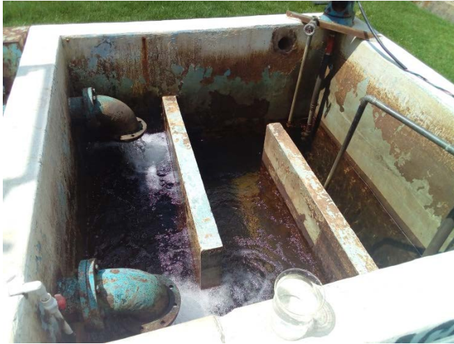
Las paredes del tanque final requieren limpieza.
