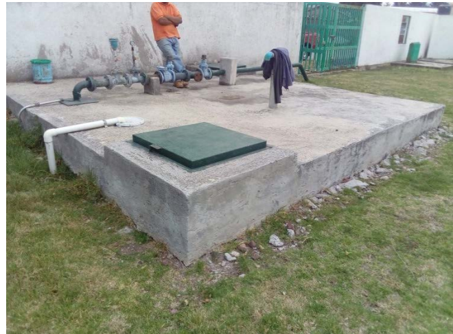
Hay vegetación alrededor del depósito y se aprecia la falta de mantenimiento.
