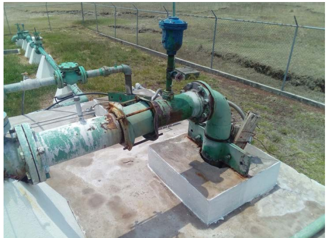
La tubería del depósito se encuentra en malas condiciones.
