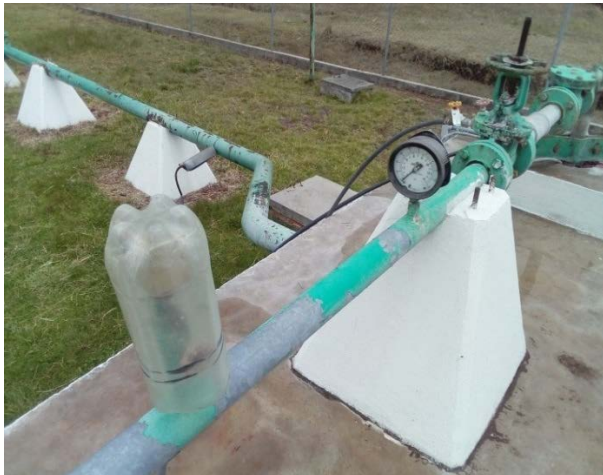
Uno de los manómetros no funciona.
