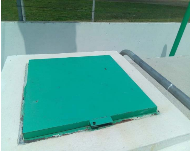
La puerta de acceso al cárcamo del depósito del agua no se encuentra asegurado.
