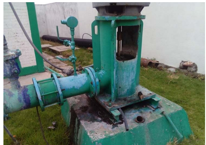
La falta de limpieza del agua y aceite del equipo ha ocasionado su deterioro.
