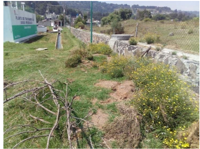
La altura de la cerca que rodea la planta no es la adecuada para impedir el paso a personas ajenas a la misma. Se pueden apreciar las condiciones de descuido en que se encuentra.
