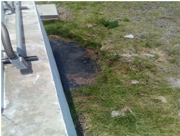
La falta de mantenimiento ha ocasionado charcos alrededor del depósito y el peligro de insectos y otros animales.
