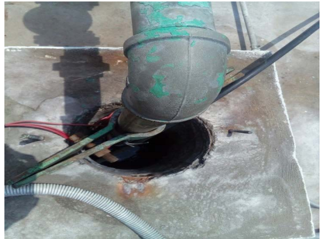
El espacio sobrante por donde entra la tubería no está cubierta; espacio por el cual se puede contaminar el agua.
