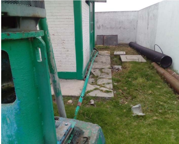
El pozo requiere mantenimiento en general.
