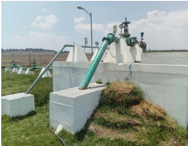
Se muestra las condiciones del depósito de agua.
