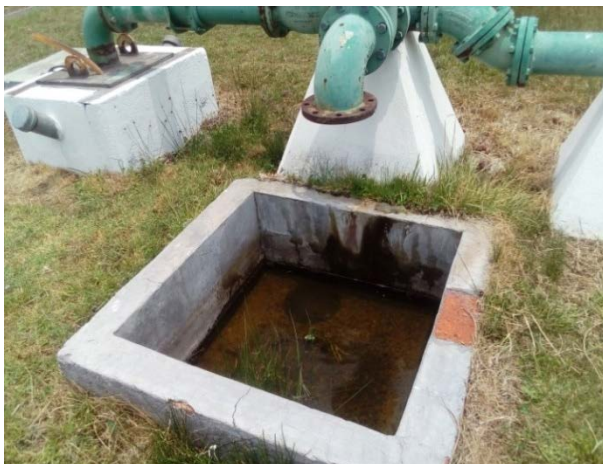
El pozo requiere mantenimiento en general.
