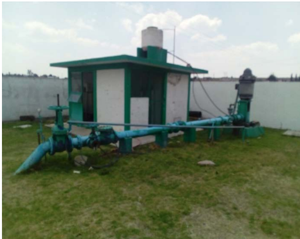
Existe vegetación que ha crecido alrededor del equipo del pozo.
