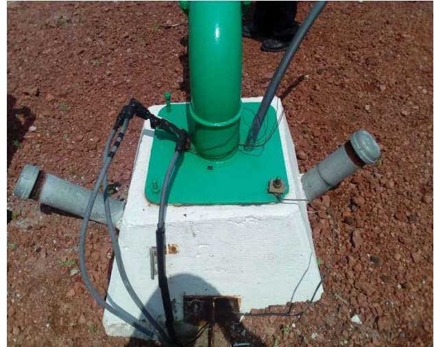
La imagen muestra las reparaciones improvisadas a las mangueras del equipo.
