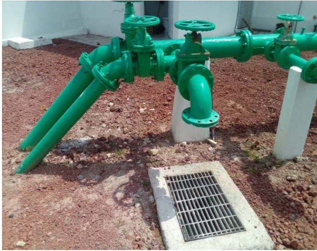
La tubería tiene una fuga.
