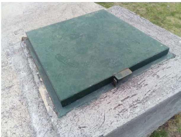
Las tapas de acceso al cárcamo del agua no se encuentran aseguradas.
