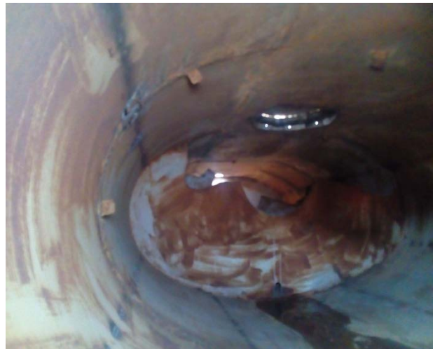
Interior de pipa cisterna 2 con oxidación y corrosión.
