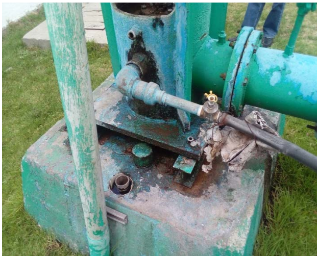
El equipo requiere limpieza y mantenimiento.
