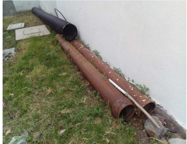
Los tubos que son extensiones para extraer el agua, se encuentran al aire libre, ocasionando su deterioro.
