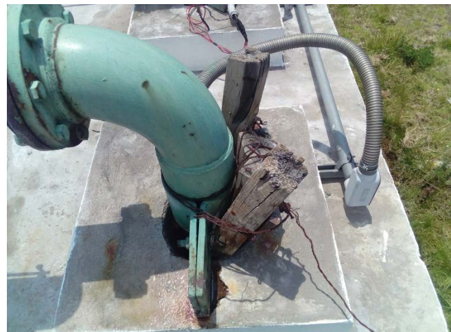
Existen reparaciones improvisadas a la tubería de la bomba del depósito.
