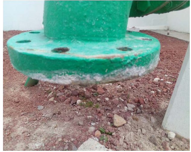
La fuga ha ocasionado el deterioro del tubo.
