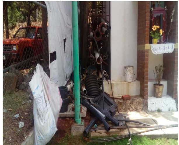
La tubería y materiales de reparación y mantenimiento se encuentran a la intemperie y desorganizados.
