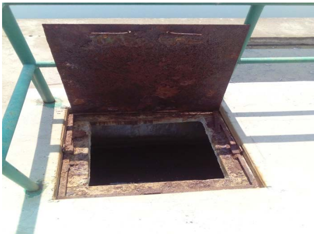
Las condiciones de las tapas de la estación de reactores presentan oxidación y no cuentan con un candado de acceso.
