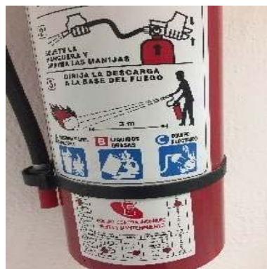
Extintor con carga caduca
