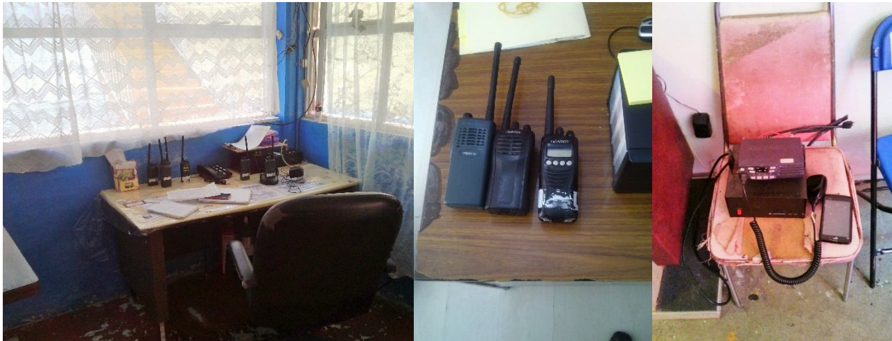
Aquí se muestra el equipo de radiocomunicación con el que cuenta la Dirección de Protección Civil y Bomberos de Jilotzingo para dar atención a la ciudadanía en la oficina central y dos subestaciones, el cual a decir del Director se encuentra obsoleto y/o no sirve.
