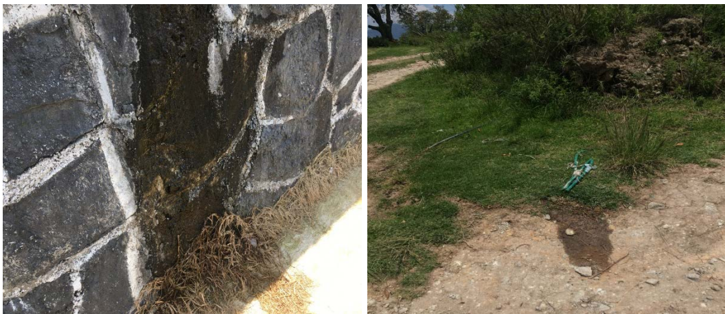
Existe una fuga en la barda del depósito del agua
