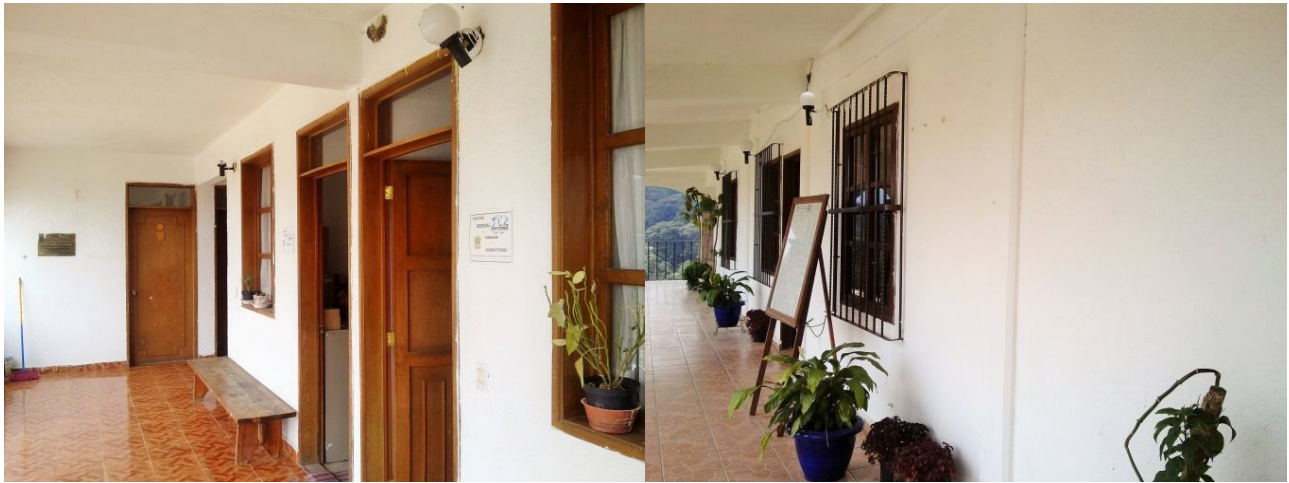
Imágenes del Palacio Municipal de Jilotzingo, en las que se observa la falta de señalamientos de protección civil, así como de extinguidores.
