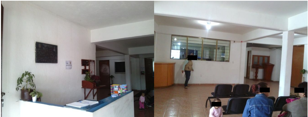
Imágenes de la planta baja del Palacio Municipal de Jilotzingo como se puede observar no existen señalamientos de rutas de evacuación, salidas de emergencia, puntos de reunión, qué hacer antes, durante y después de un sismo, así como la falta de extintores.
