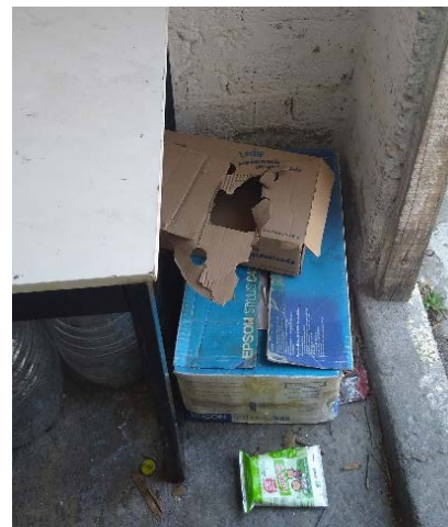
La bodega presenta un hoyo en la puerta.
