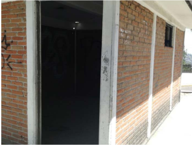
Falta de puerta en el deportivo "La Punta".
