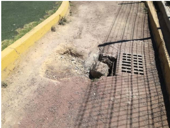
Falta de mantenimiento en la pista de atletismo del deportivo "La Curva".
