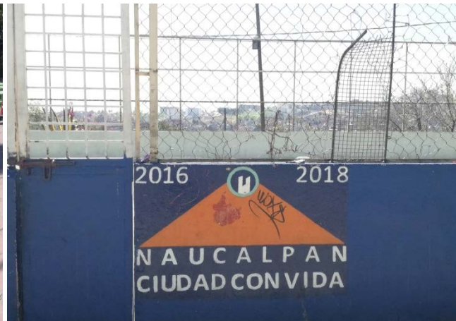
Malla en mal estado de la cancha del deportivo “El Polvorín”.
