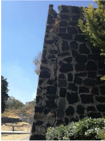
Barda con fisura (peligro) en el deportivo “Mártires de Río Blanco”.
