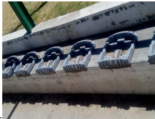
Falta de asientos en las gradas "La Curva".
