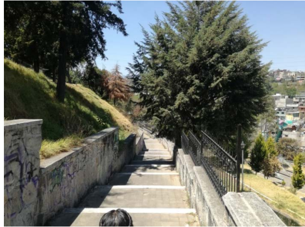
Falta de barandal en el deportivo "La Punta".
