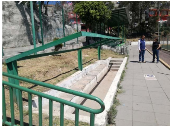
Falta de techumbre en la grada, "deportivo la curva".
