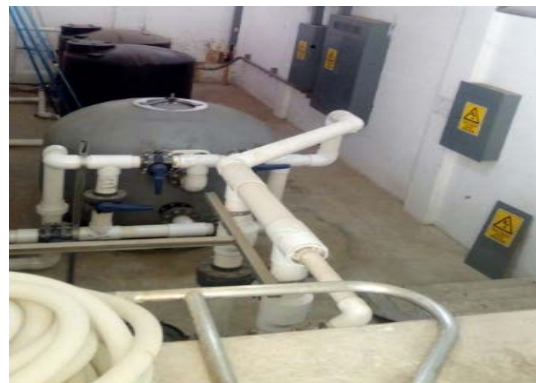
Cuarto de Máquinas "Alberca la Mancha".
