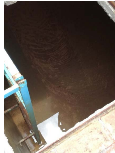
Falta de limpieza del tanque.
