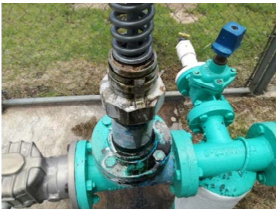
Fuga en la válvula.
