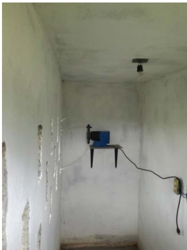
Bomba de cloración desconectada.
