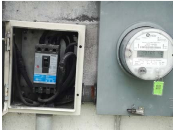
Interruptor exterior abierto.
