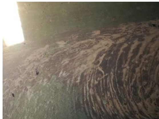
Tierra en el fondo del tanque.
