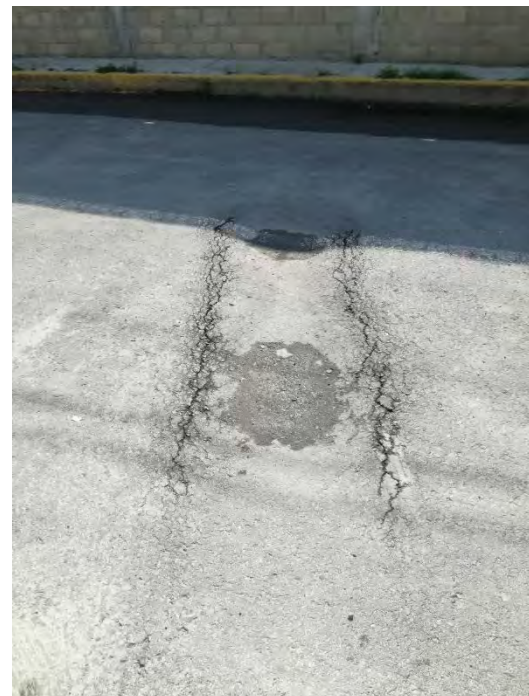
Hundimiento de calle por mala compactación.
