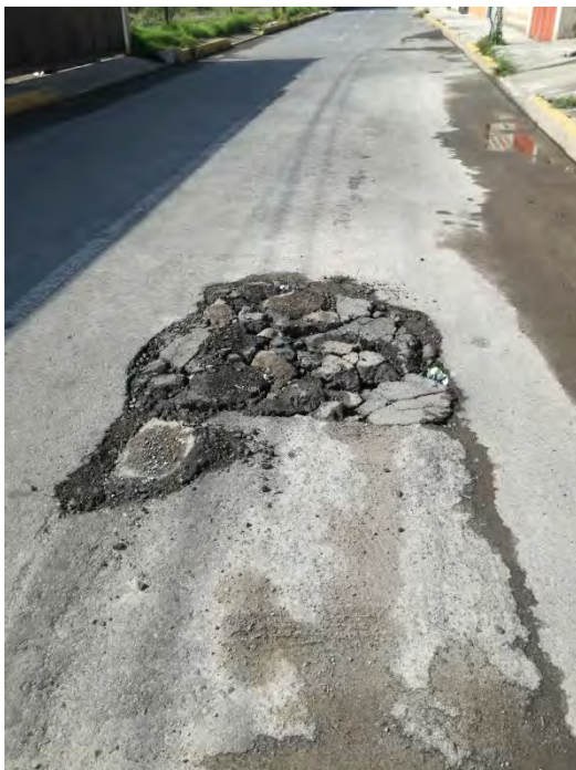
Pavimento levantado y no se vuelve a reparar.
