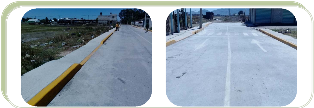
Pavimentación asfáltica en calle Fresnos, de calle 15 de Septiembre al cad. 0+000; Tonanitla, Estado de México.
