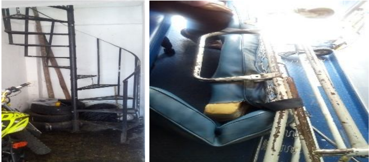
Instalación inadecuada de la Dirección de Protección Civil, toda vez que para acaezar se tiene que hacer uso de una escalera metálica deteriorada, la cual puede colapsar, y Camilla deteriorada.
