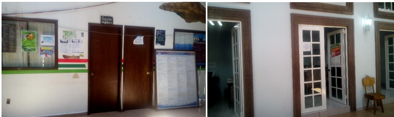
Oficinas de Regidurías, Contraloría y Administración, no cuentan con señalizaciones y extintores.
