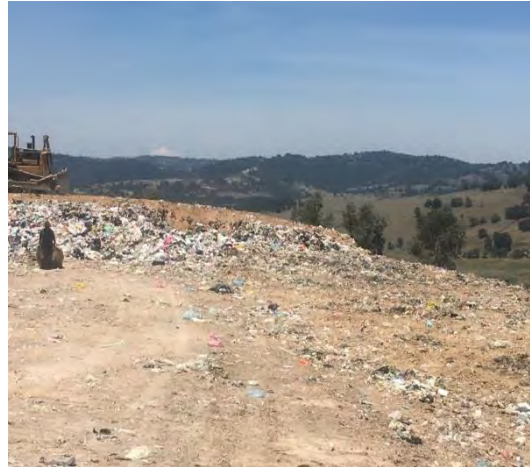
Carencia de fosas y chimeneas para la liberación del gas.
