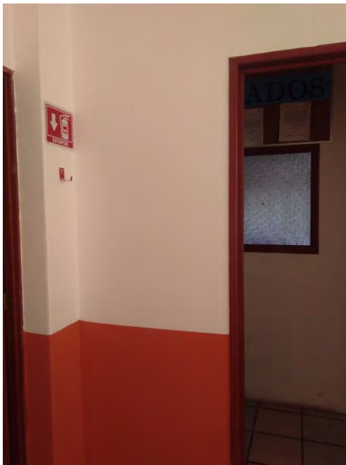
Señalización sin extintores
