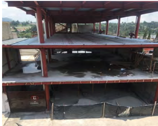
Construcción en Calle Vicente guerrero, sin exhibición de la licencia correspondiente.
