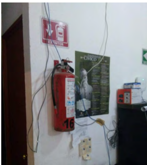
Extintor fuera del armero presenta carga caduca y exceso de cables.
