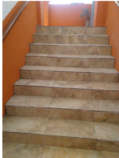
Escaleras sin cinta anti derrapante
