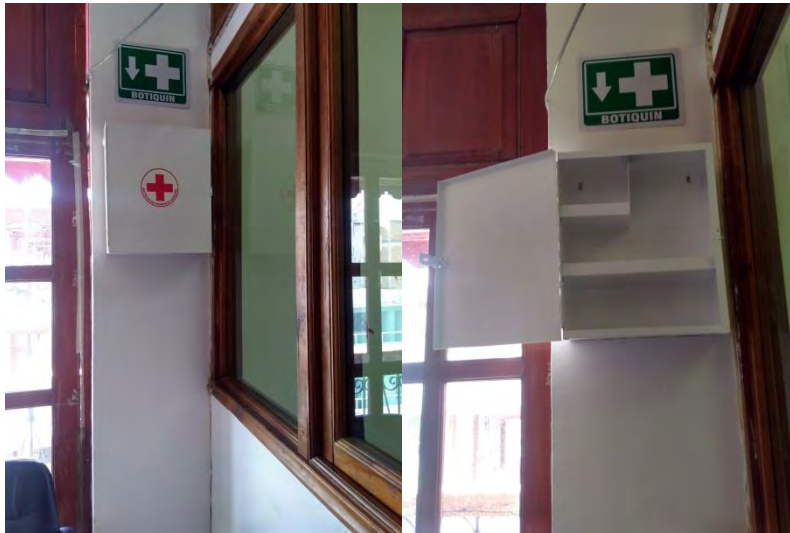
Botiquín sin insumos
