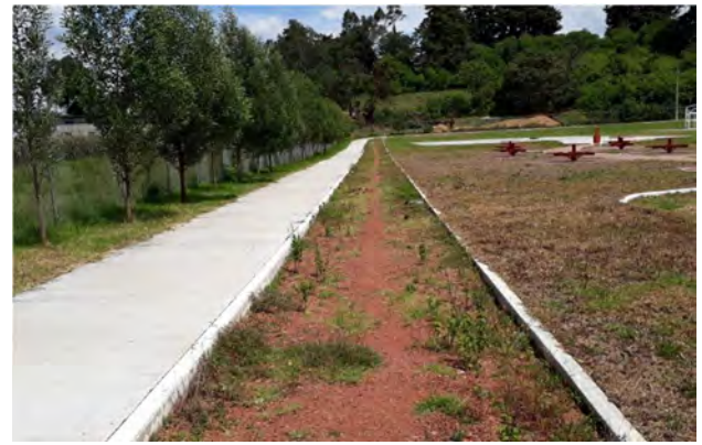
La pista para correr no ha tenido mantenimiento y las condiciones en que se encuentra no son las óptimas para su uso.
