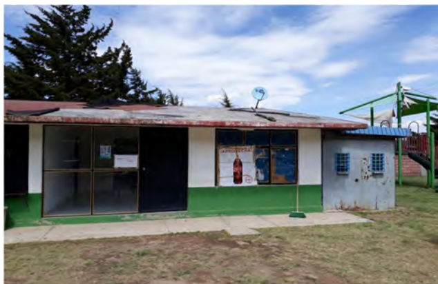
El techo de la tienda requiere mantenimiento.
