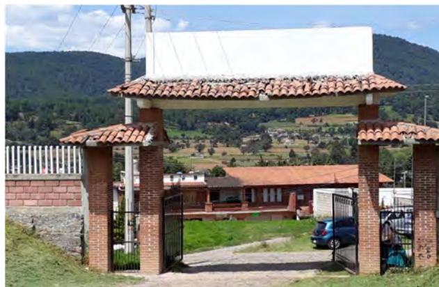
La teja de la entrada principal representa un peligro al estar en malas condiciones.
