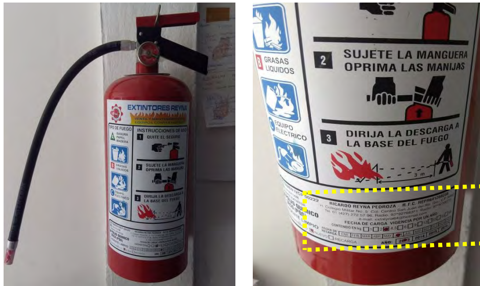
Extintores del consultorio médico con carga caduca.
