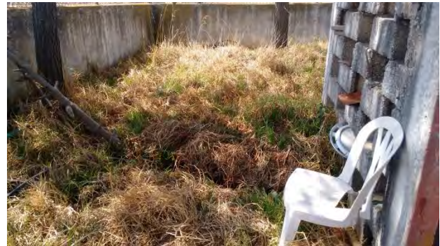
Se observa maleza en el perímetro del pozo.
