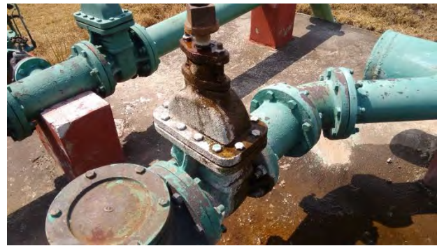
La válvula del pozo tiene fuga, provocando la oxidación.
