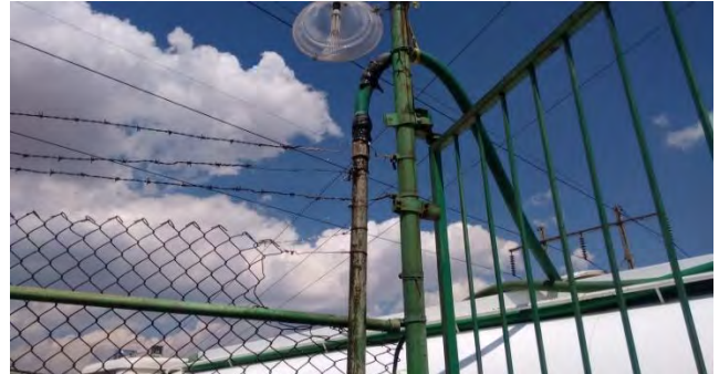
Garza improvisada y con fuga de agua.
