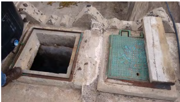
Registro de acceso del cárcamo sin tapa.
