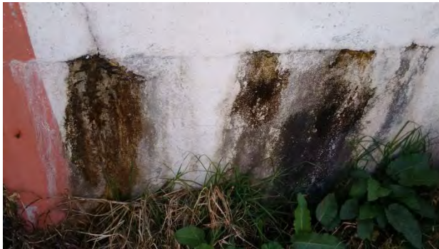
Paredes del cárcamo con filtraciones.
