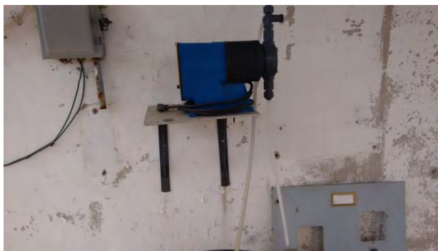
La bomba dosificadora de hipoclorito del pozo se encuentra desconectada de la energía eléctrica.
