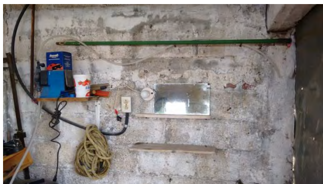
La bomba dosificadora de hipoclorito se encuentra desconectada.
