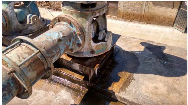
La base de la bomba tiene fuga de agua.
