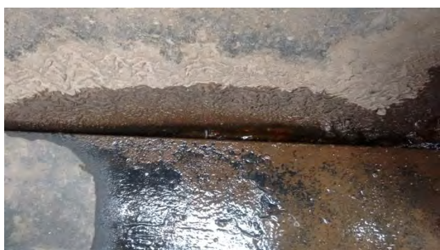
Fuga de agua en la parte inferior de la cisterna.
