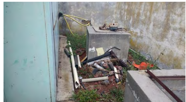
Material eléctrico acumulado.
