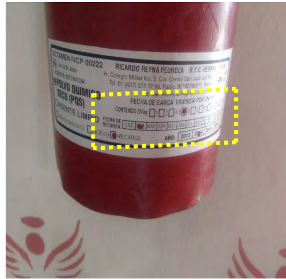
Extintor con carga caduca.
