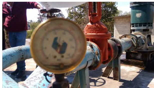
Manómetro sin funcionar.
