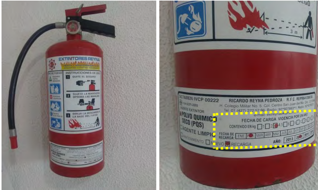
Extintores con carga caduca.
