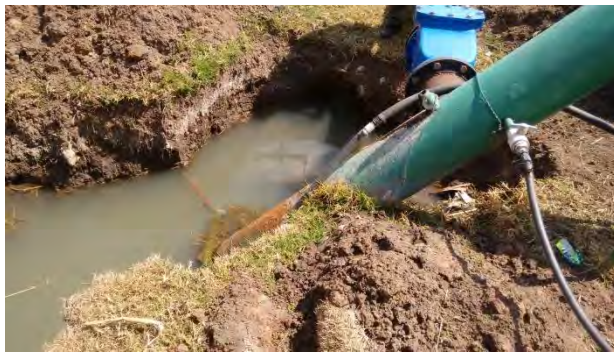
Perforación inundada, sin rellenar.
