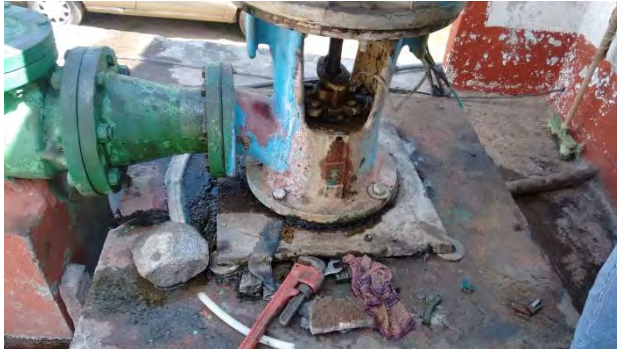
Fuga de agua en la base de la bomba.
