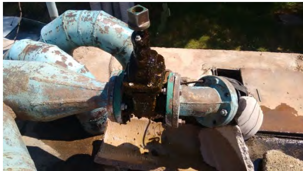
La válvula presenta fuga y oxidación.
