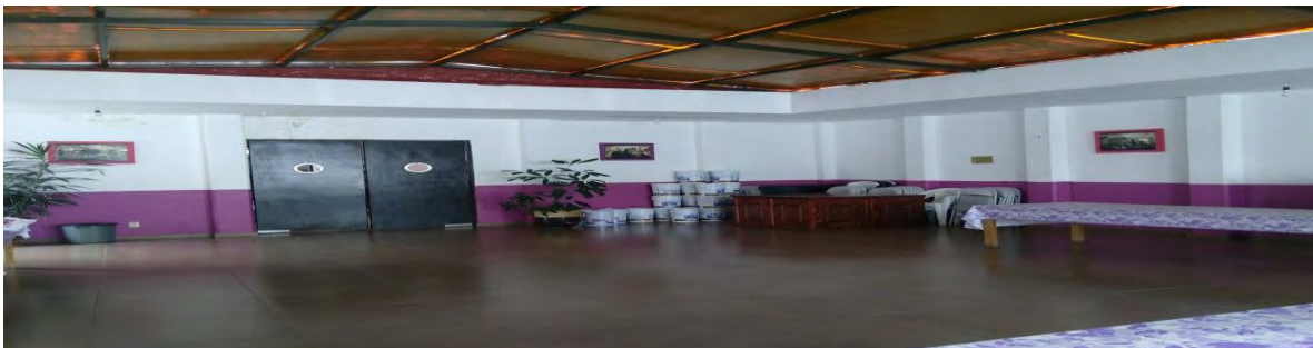
El salón donde se realizan actividades con grupos de adultos mayores no cuenta con señalamientos.
