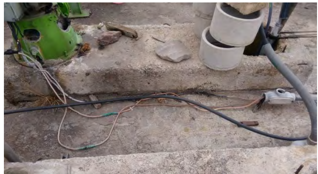
Cables de energía eléctrica sin tubo de protección.
