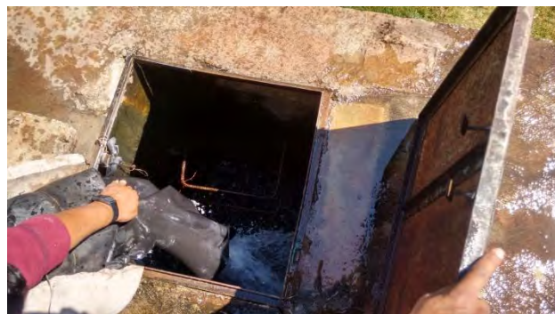
Tapa del registro de acceso desoldada.
