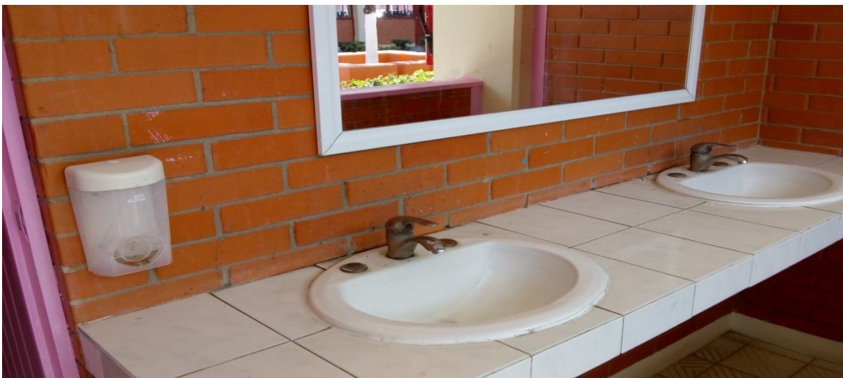
Los baños de hombres y mujeres no cuentan con jabón para el aseo personal.
