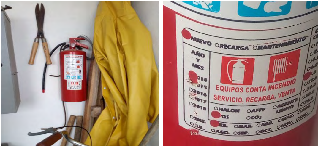
Ejemplo de extintores sin recarga desde 2014 y obstaculizados.
