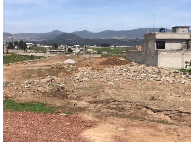
Obra de urbanización sin licencia.
