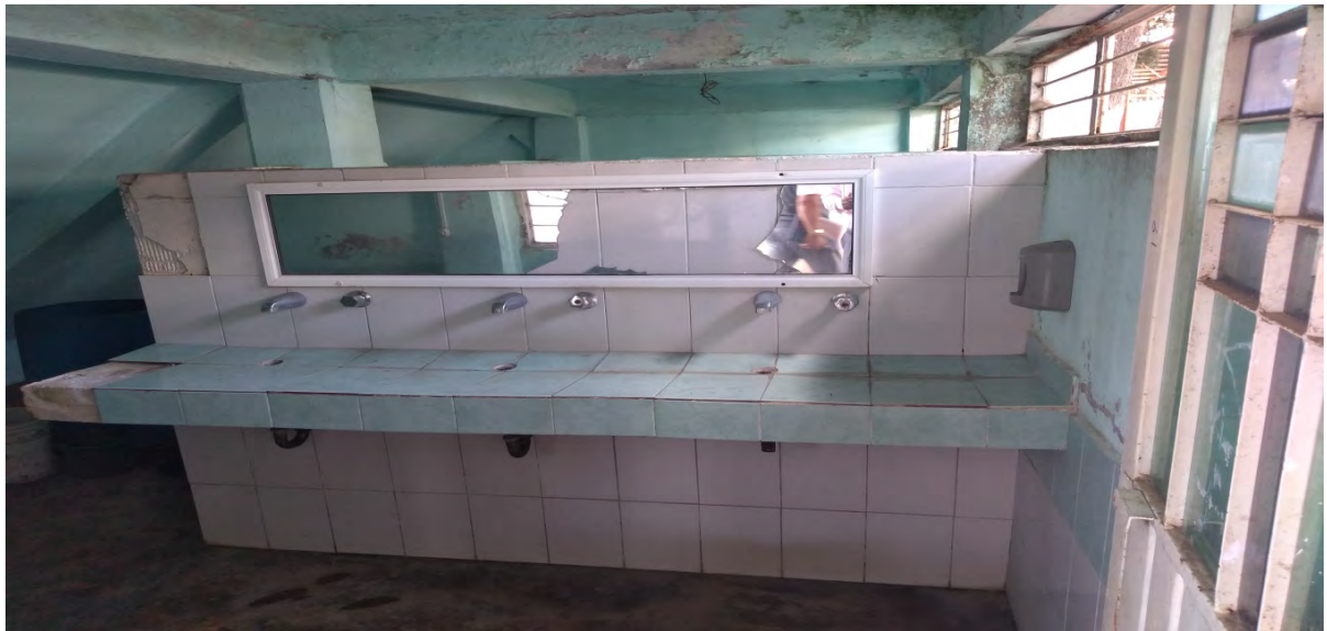
La fotografía muestra la falta de mantenimiento de los sanitarios, los cuales no están funcionando.
