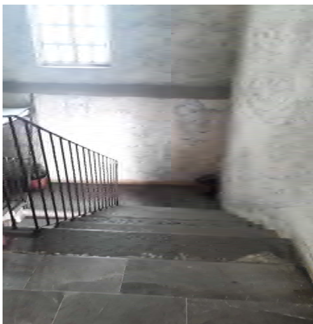
Las escaleras que se encuentran en el inmueble de la Presidencia Municipal, no cuentan con cinta anti-derrapante.
