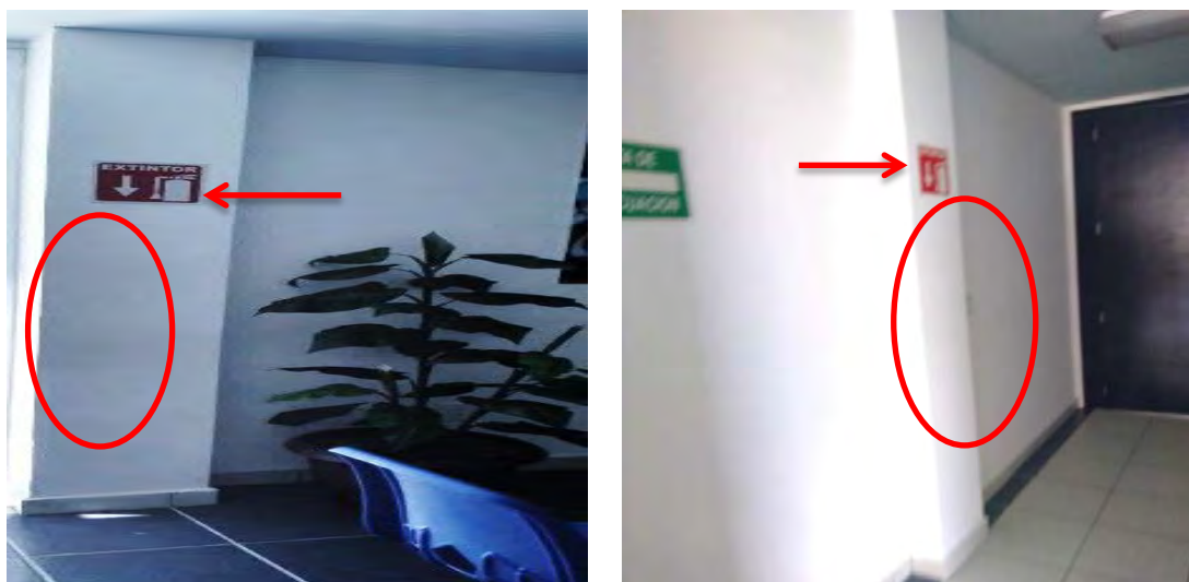
Se observa que existen señalamientos sobre la ubicación de los extintores; sin embargo, estos no se encuentran físicamente.
