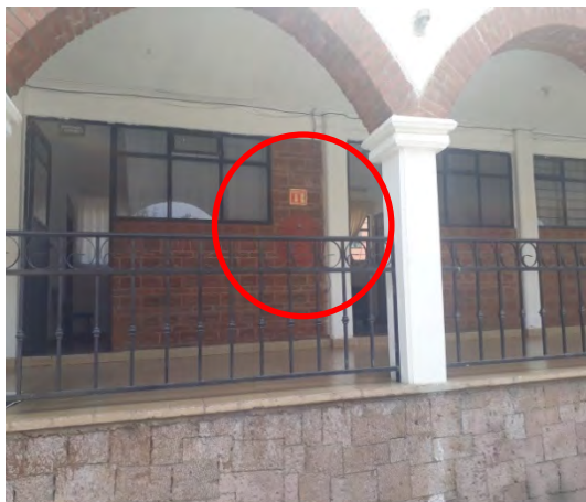
No existe extintor en el lugar señalado
