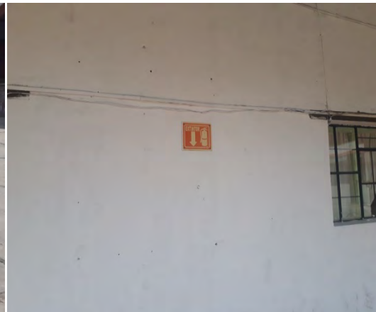
No hay extintores
