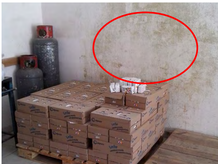
El almacén presenta humedad en pared, así mismo se encontraron cilindros de gas L.P.
