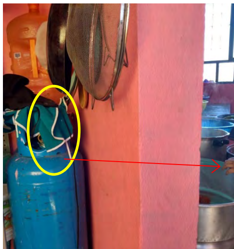
Tanque de Gas L.P, en el área de cocina, además de obstrucción de la llave de cerrado.
