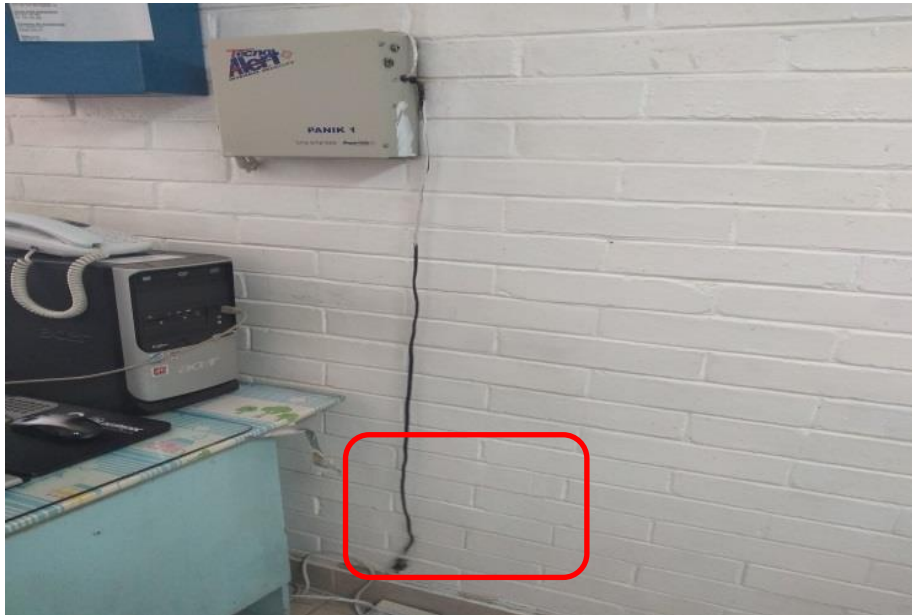
Como se aprecia en la imagen, la estancia infantil cuenta con alerta sísmica; sin embargo, no se encuentra conectada.
