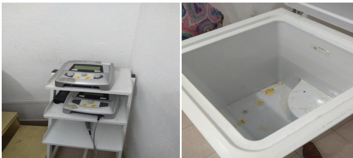
La primera imagen corresponde al equipo de Electroterapia, en el cual el electroestimulador no cuenta con los cables de corriente y de electrodos. La segunda fotografía refiere a un refrigerador descompuesto, el cual se utiliza para las compresas.
