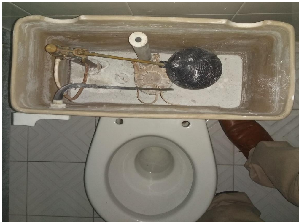
El tanque de almacenamiento de agua presenta fugas, es por ello que no se encuentra funcionando.
