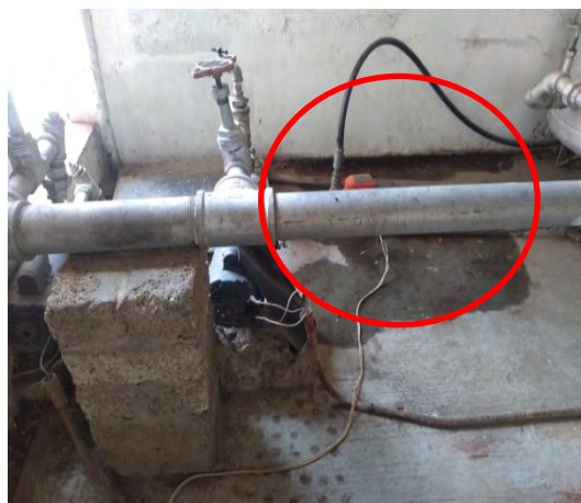
Área de calderas de la alberca.
