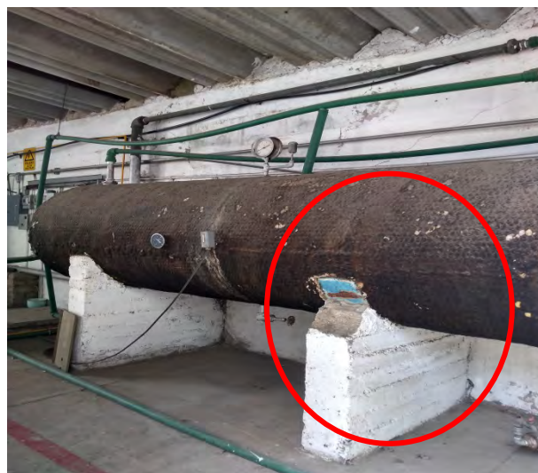
No cuentan con bitácoras de mantenimiento preventivo y/o correctivo. Se observó que el tanque de agua está muy deteriorado.
