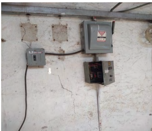
En el área de calderas de la alberca no todas las instalaciones eléctricas cuentan con señalización.
