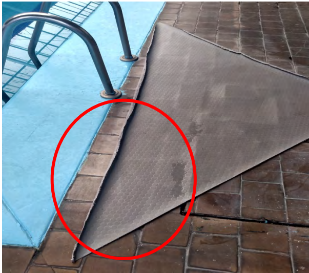
Los tapetes antiderrapantes se encuentran deteriorados.
