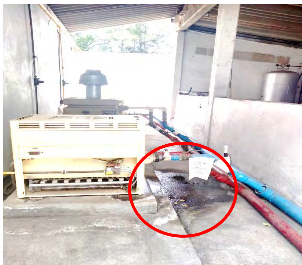
En el área de la caldera se carece de señalización de restricción y presenta fugas.
