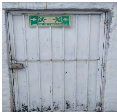
Señalización informativa, la puerta no abre en sentido al flujo de salida de las personas.
