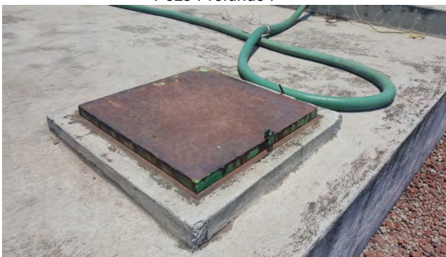
Pozo Profundo I
