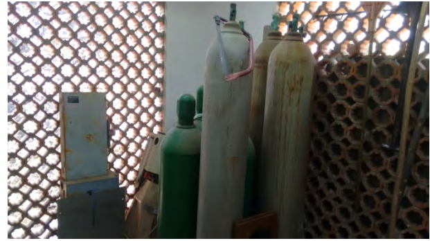
Tanques de cloro vacíos.
