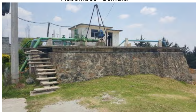
El pozo de rebombeo, se encuentra sin protección alguna.
