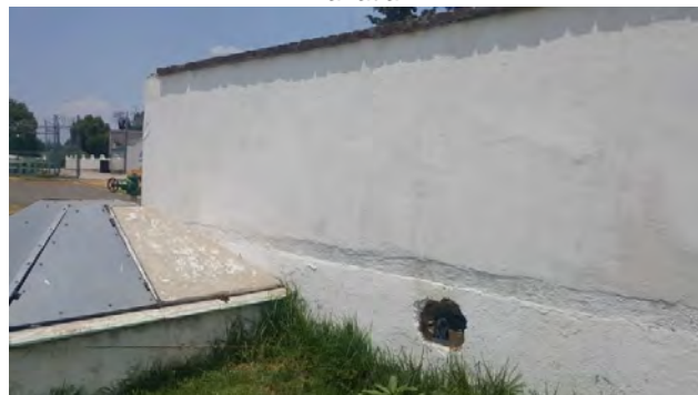
En el Manantial I, se observa un agujero en la pared, que permite la entrada de animales directamente al área de bombeo, pudiendo llegar a provocar algún accidente o daño al equipo.
