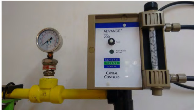
Equipo de dosificación apagado.
