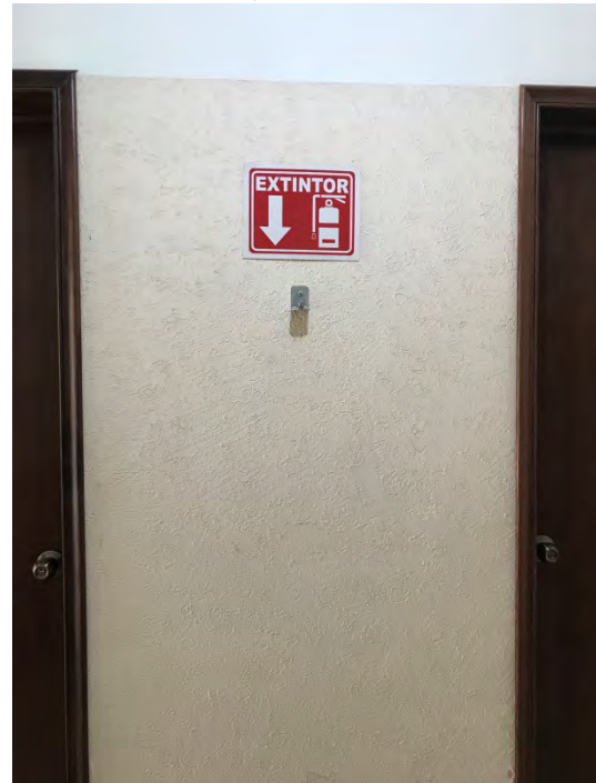
Anuncio de extintor que no se encuentra físicamente.
