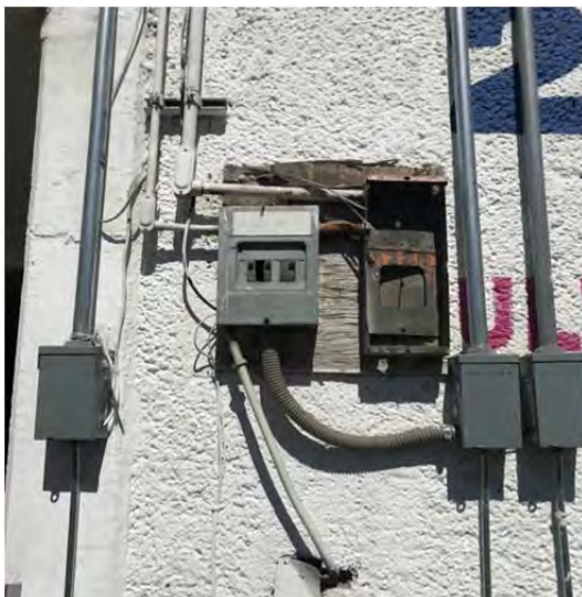
El tablero de la entrada principal se encuentra en mal estado.
