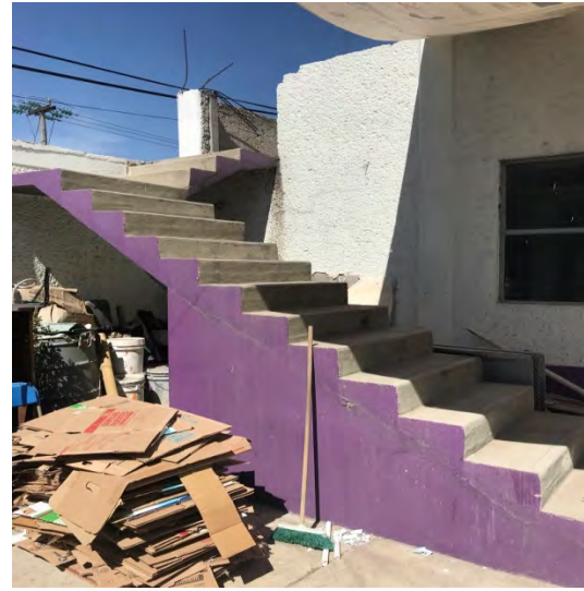
Falta de señalización y de barandal en la escalera.
