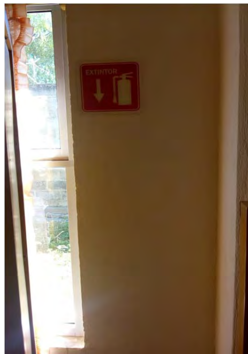
Letrero de extintor sin extintor.
