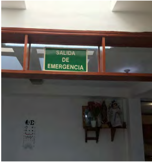
Señalización de salida que no existe.
