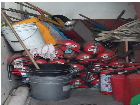
Extintores almacenados en la Coordinación de Protección Civil y Bomberos.
