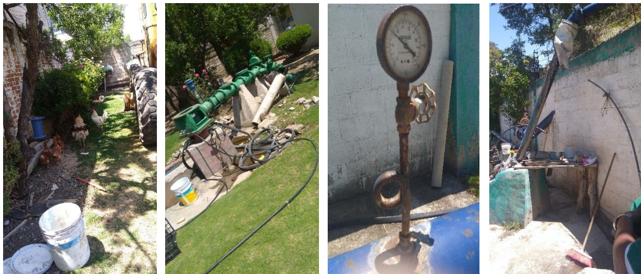
Los pozos presentan falta de mantenimiento, así como objetos y fauna ajenos a estos.
