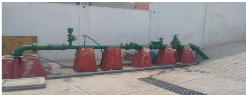
Pozo sin señalización en materia de protección civil tales como rutas de evacuación, punto de reunión.
