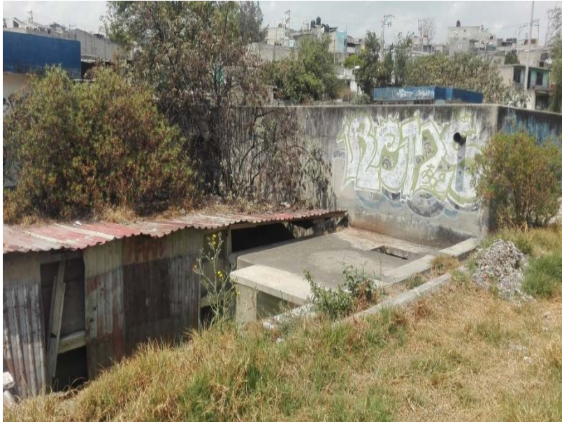
Planta tratadora de aguas residuales "Fuentes de San José" fuera de funcionamiento.
