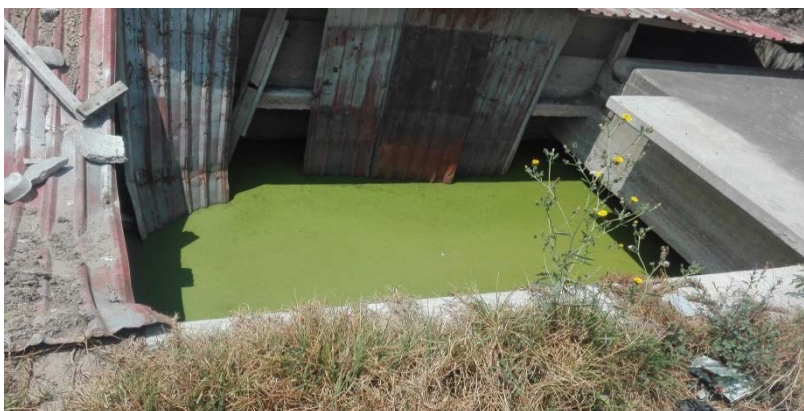
Planta tratadora de aguas residuales "Fuentes de San José" fuera de funcionamiento.
