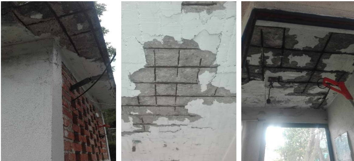
La evidencia muestra paredes y lozas deterioradas debido a la erosión del cloro, lo cual representa un riesgo para el personal.
