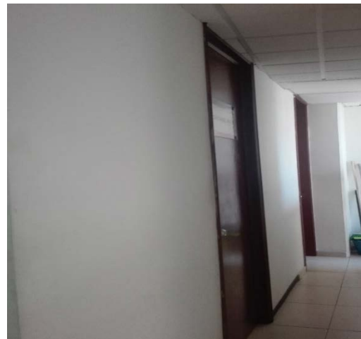
El inmueble no cuenta con señales de tipo, restrictivo, de prevención y de obligación.
