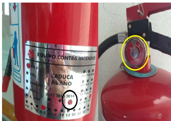
Extintor ubicado en la entrada del Departamento de Control y Registro Patrimonial.
