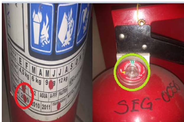
Extintor ubicado en la armería de la Coordinación de Seguridad Pública.
