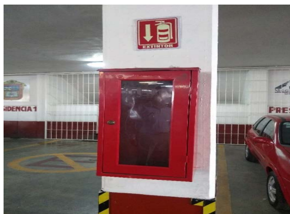
El estacionamiento del Ayuntamiento carece de extintores a pesar de que cuenta con 7 señalizaciones.
