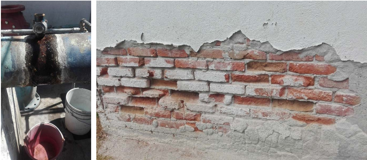
Se observa oxidación en la tubería, así como deterioro de las paredes del inmueble.
