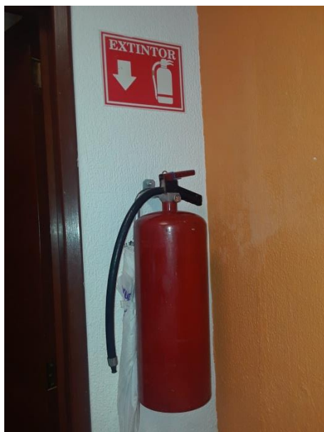
Extintor ubicado en una oficina de Presidencia, sin etiqueta.
