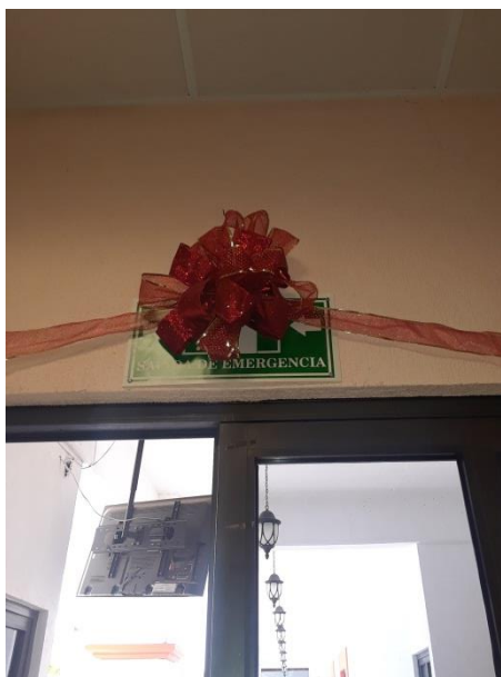
Se observa el señalamiento obstruido.
