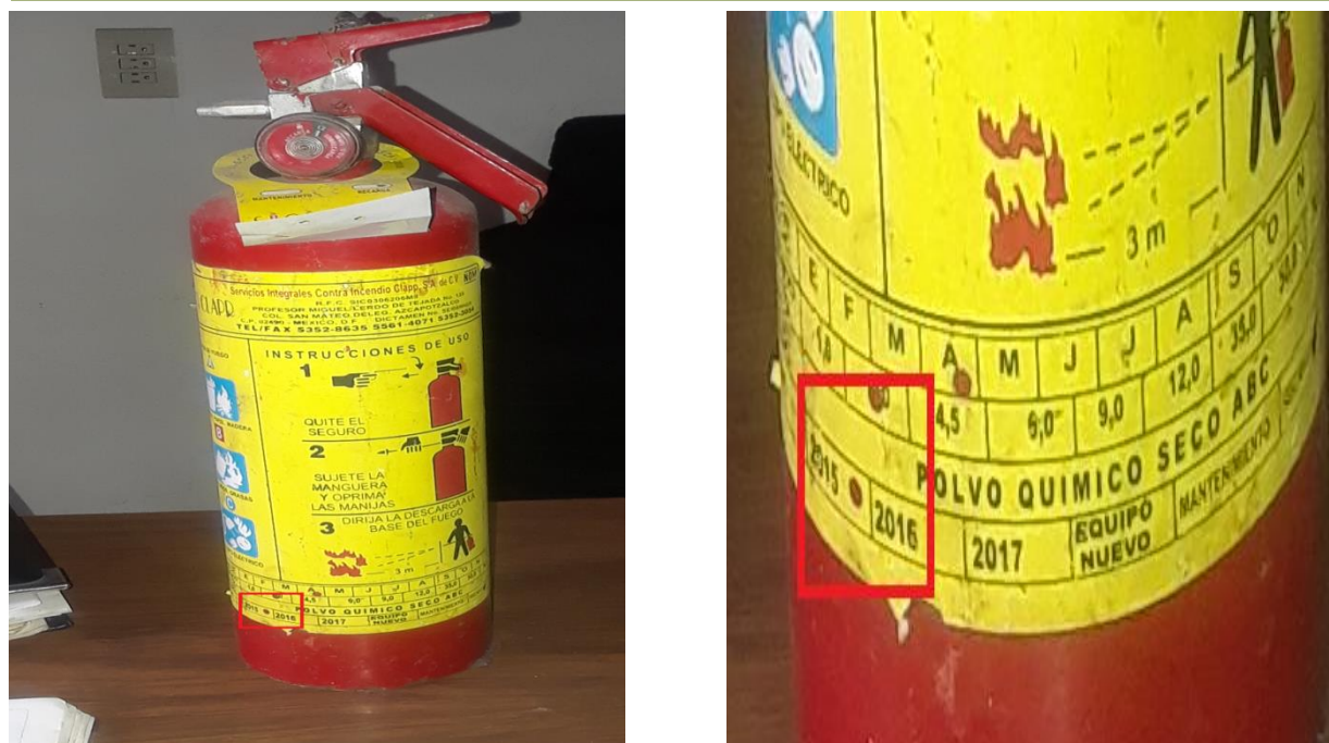
Extintor con fecha de última carga en el año 2015.
