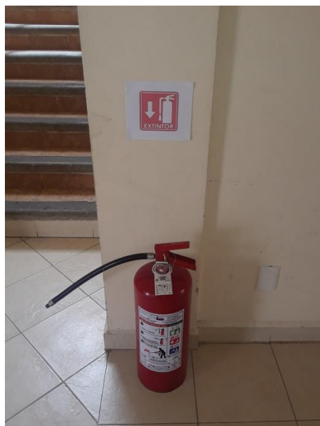
Extintor ubicado en la Estación de Protección Civil y Bomberos.
