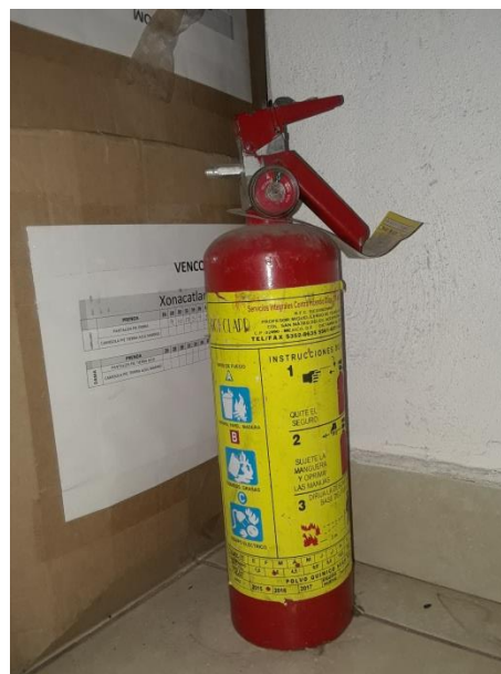
Extintor ubicado en la armería de la Dirección de Seguridad Pública, con carga caduca desde el año 2015.
